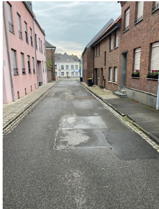
○ Flickenteppich im Asphalt durch Versorger
